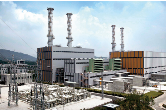
포천 CCPP 전경
