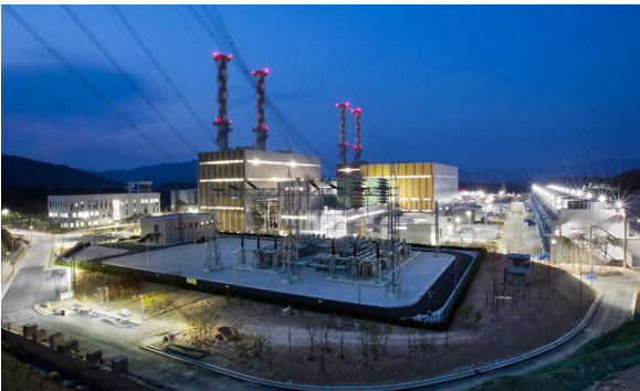
포천 CCPP 전경
